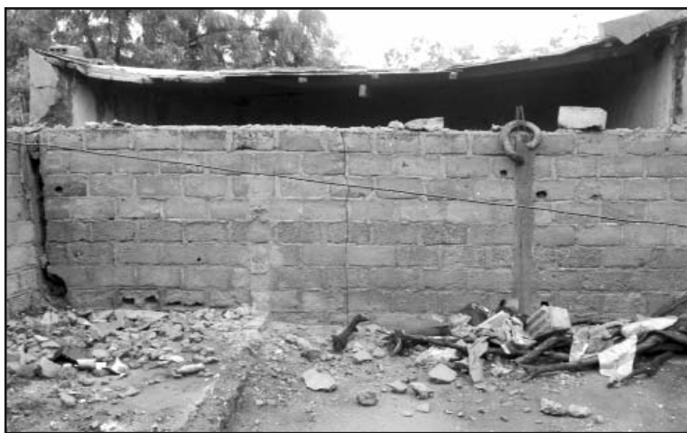
Une vue d'une maison détruite par la pluie
